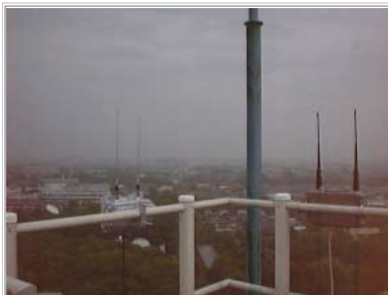
図6 鉄塔上に設置したレピータ(2基)
