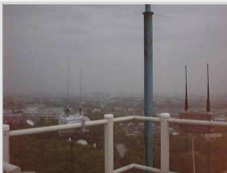
図6 鉄塔上に設置したレピータ(2基)
